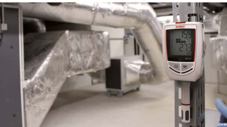
KT220 aimanté dans le local de traitement d'air d'une infrastructure industrielle.
